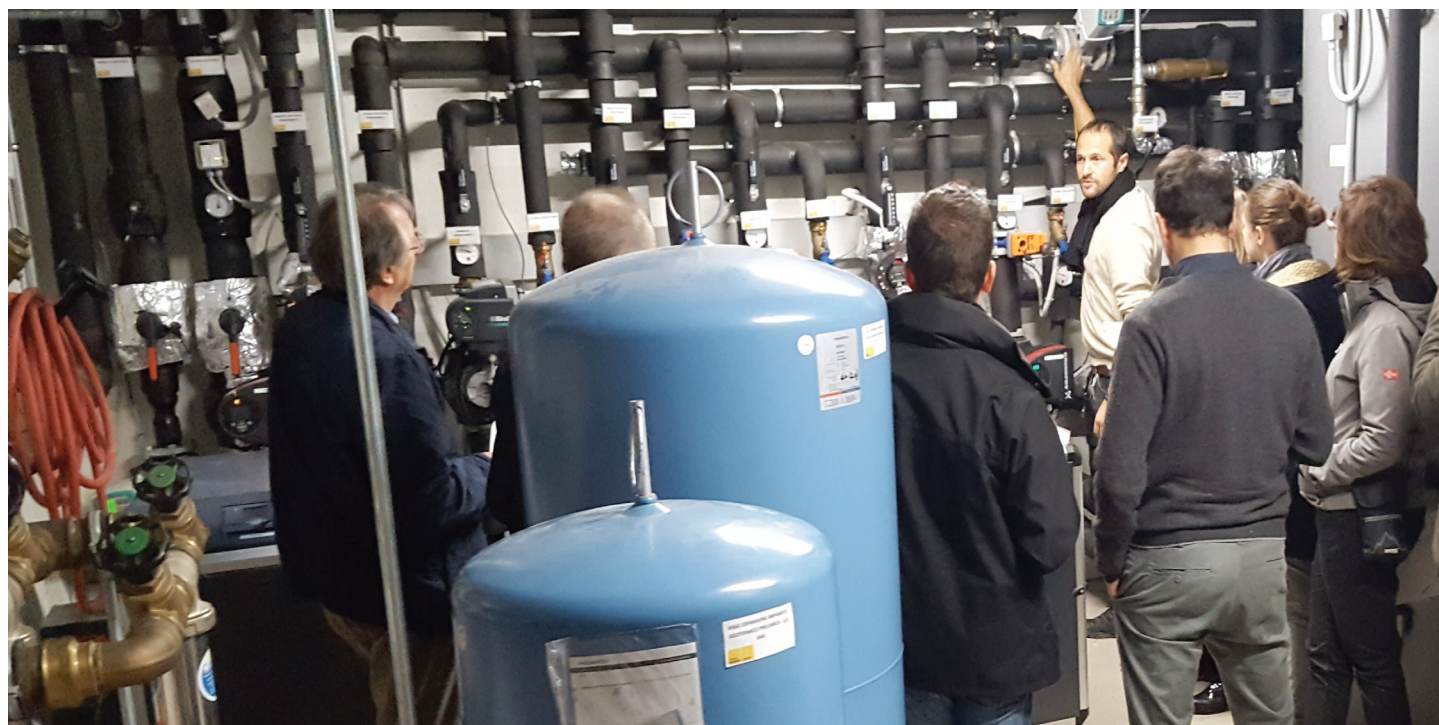
Il progetto di geocooling ha riscosso un grande interesse tra gli operatori del settore. Marco Belliardi spiega l'impianto ai visitatori. Foto: SUPSI
