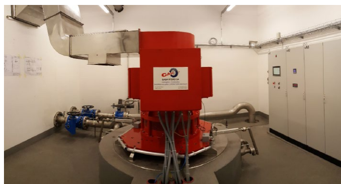
Turbina e generatore della centrale di Pontet (immagine: Gasa Hydro SA)
