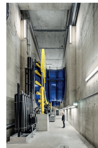
Il cuore ultramoderno della centrale idroelettrica di Hagneck.
