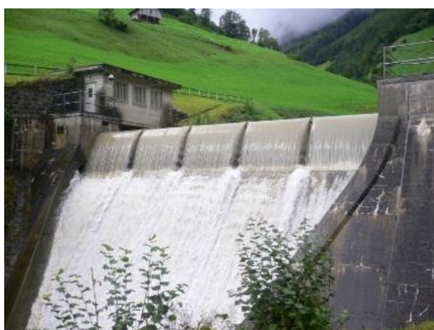
Figura 5: scarico di superficie impianto di accumulazione di Isenthal UR
