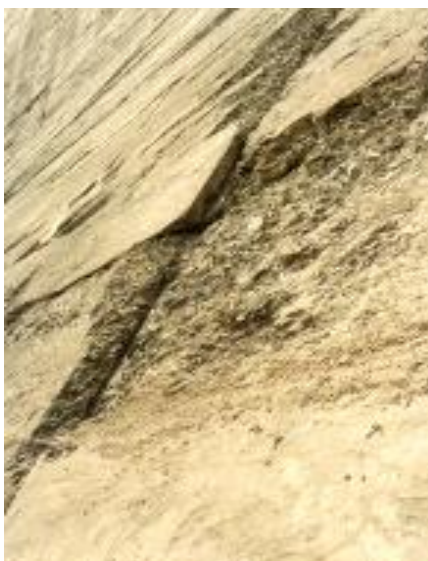
Figura 8c: rigonfiamenti di una diga
