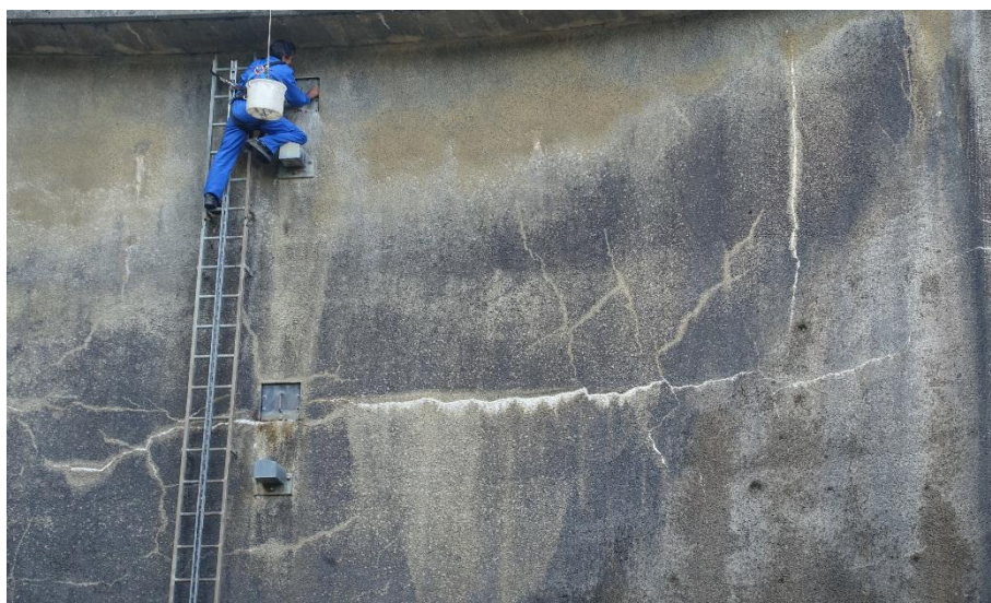
Figura 8d: crepe in una diga in muratura
