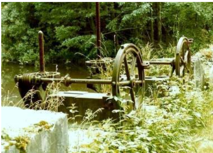
Figura 8f: stato dei componenti elettromeccanici
