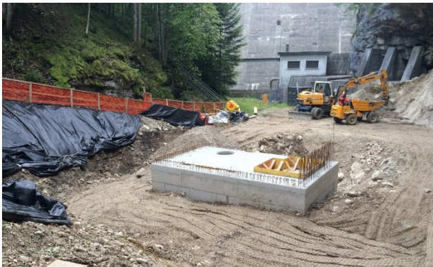
La centrale ad acqua di dotazione Day ai piedi della diga di sbarramento, semi-sotterranea e al momento ancora in costruzione (Sett. 2014, © Romande Energie)
