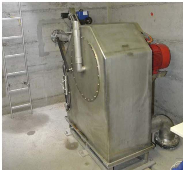
Turbina nel serbatoio acqua potabile
