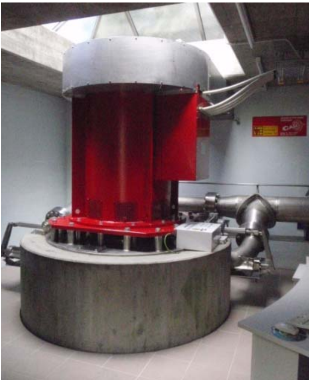
La turbina Pelton a due ugelli e il generatore dell'impianto di acqua potabile di La Rasse, con una potenza di 750 kW.
