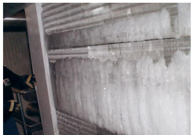
Figura: evaporatore ghiacciato. L'aria attraversa soltanto una parte della superficie.
