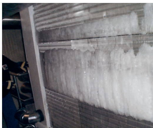
Figura: evaporatore ghiacciato. L'aria attraversa soltanto una parte della superficie.
