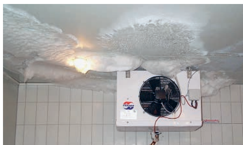
Fig. Formazione di ghiaccio sul soffitto e sulla parete
