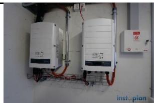
Figura 24: inverter dell'impianto fotovoltaico
