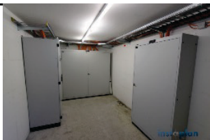
Figura 23: distribuzione principale centralina elettrica
