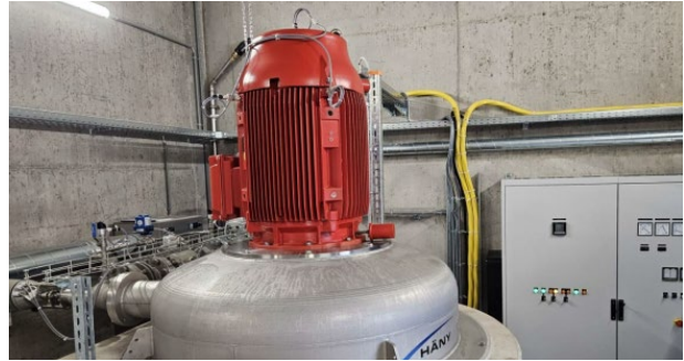
Piccola turbina Pelton dimensionata appositamente per il sito con una potenza di 117 kW per una portata di 30 l/s e un dislivello netto di 467 m, messa in funzione nel settembre 2025, utilizzo dell'acqua potabile del comune di Schwanden (GL) (fonte: Häny & Kobel Elektrotechnik AG)
