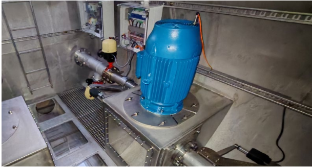
Piccola turbina Pelton standardizzata da 15 kW per una portata di 32 l/s e un dislivello netto di 58 m, messa in funzione nel gennaio 2026, utilizzo dell'acqua potabile del comune di Zillis-Reischen (GR) (fonte: ENSY AG)
