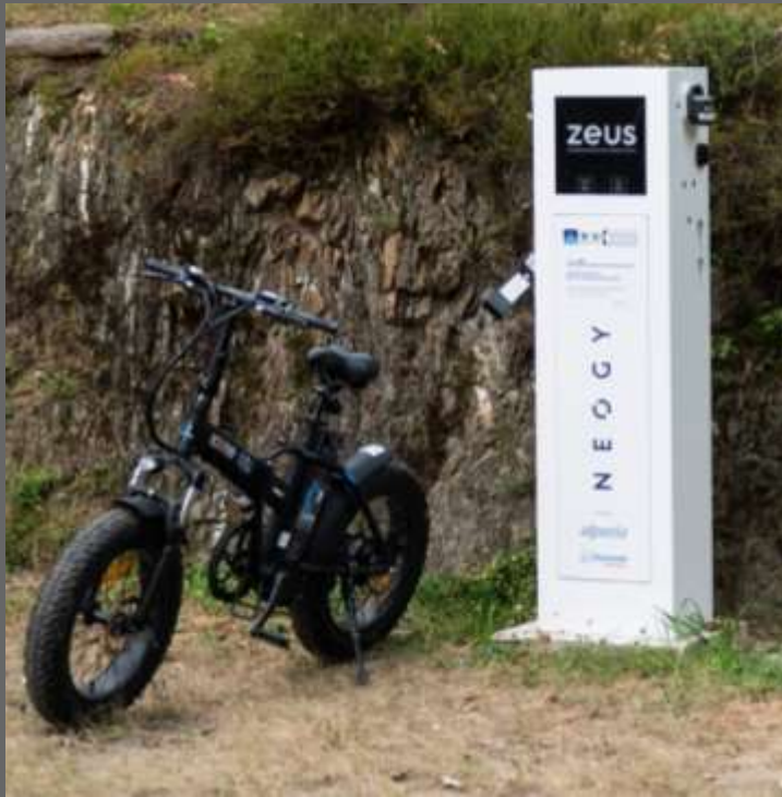
Stazione con prese standard, alimentata da rete (si noti il carica-batterie del ciclista a sinistra). Stazione installata nell'ambito del progetto Interreg MOBSTER nel VCO (crediti: Luca Meneghel per progetto MOBSTER)
