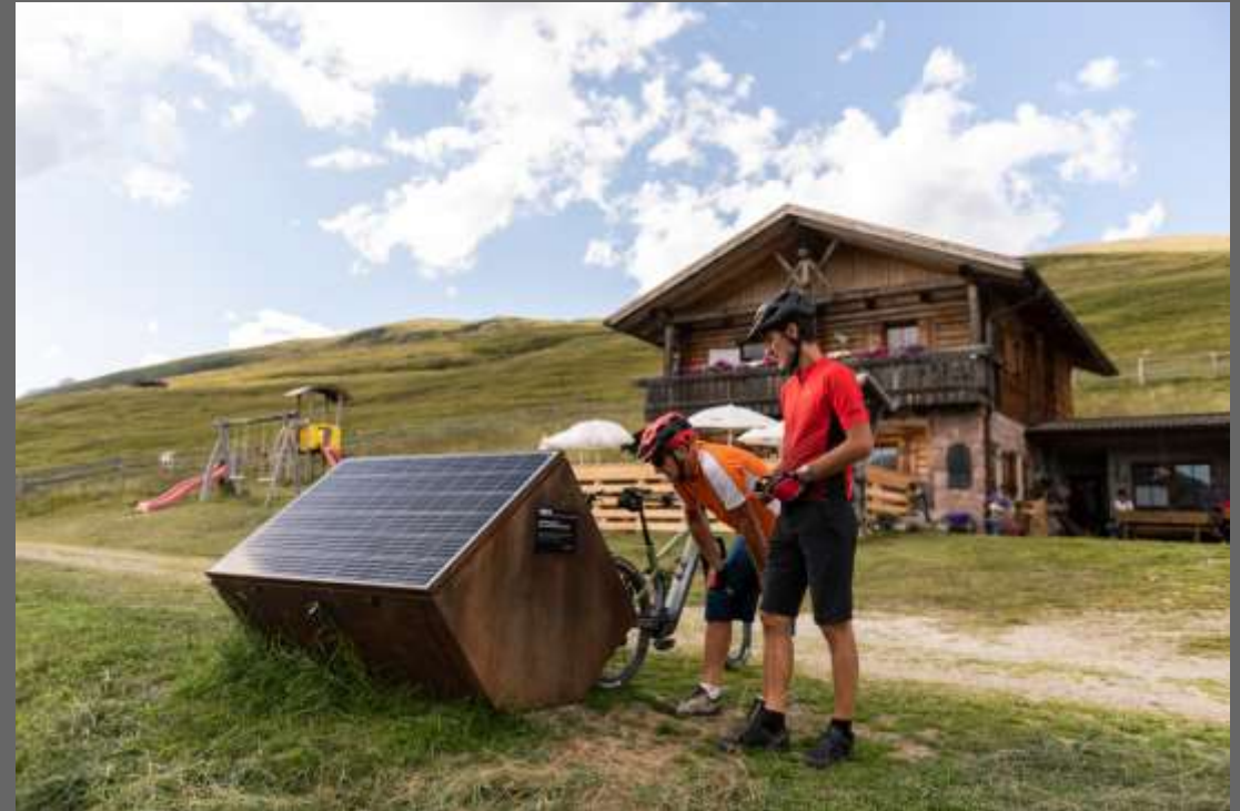
Stazione con pannelli fotovoltaici integrati, con prese standard. Stazione installata nell'ambito del progetto Interreg MOBSTER presso una capanna in provincia di Bolzano (crediti: Luca Meneghel per progetto MOBSTER)
