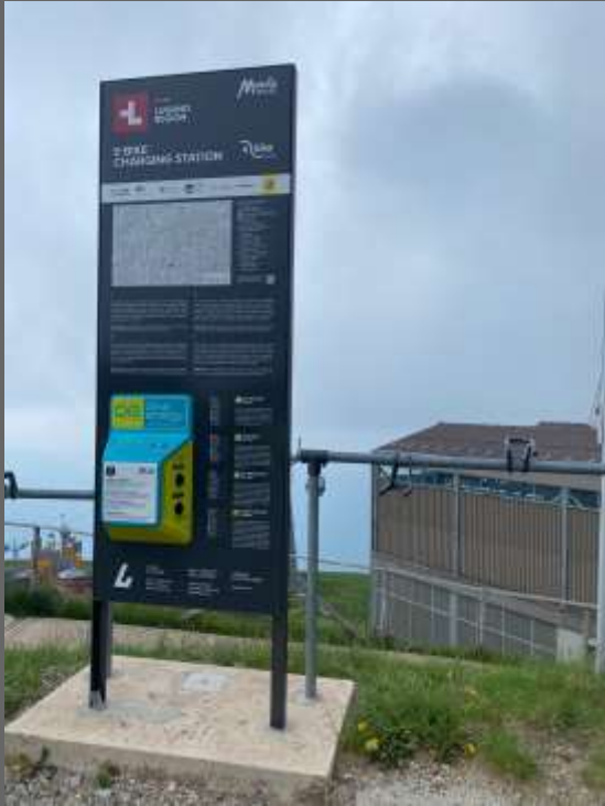
Stazione con caricabatterie incorporato e prese dedicate, alimentata da rete. Stazione utilizzata in Ticino sui percorsi per e-MTB
