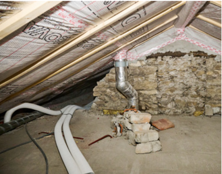
Vista del solaio: i tubi grigi della ventilazione raggiungono tutti i locali dell'edificio.
