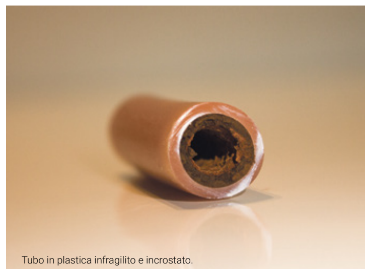
Tubo in plastica infragilito e incrostato.
