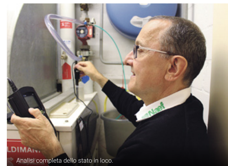
Analisi completa dello stato in loco.
