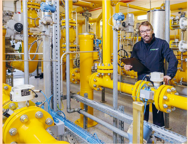
Figura 3: Stazione di riduzione della pressione e misurazione (fonte: Energie 360°).
