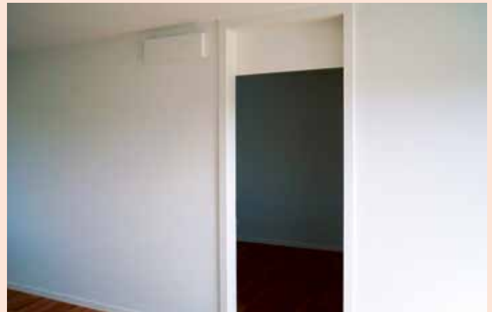
Figura 3.8: Il ventilatore di collegamento a sinistra, sopra la porta, convoglia aria dalla camera da letto al soggiorno.
