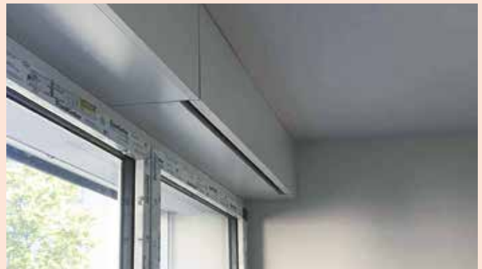
Figura 3.16: Gli apparecchi di ventilazione per singolo locale sono stati collocati negli allargamenti del telaio delle finestre senza particolari problemi. (Fonte: Ventoswiss AG)
