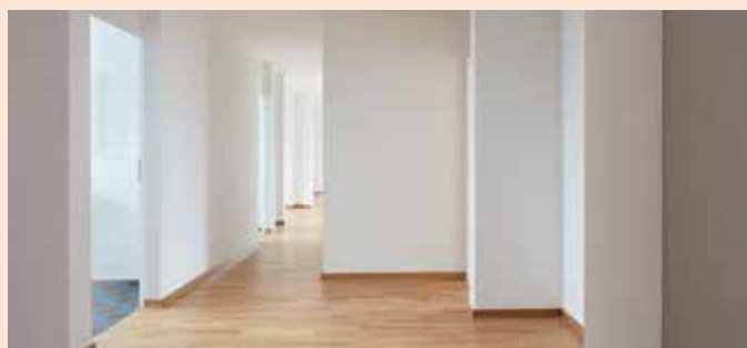
Figura 3.11: L'aria immessa entra nel corridoio attraverso il passaggio d'aria sopra la porta del bagno (a sinistra). Nel caso di una distribuzione dell'aria convenzionale, sarebbe stato necessario un controsoffitto che avrebbe nascosto il lucernario. (Fonte: Ralph Feiner)
