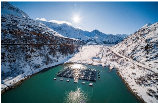
© Romande Energie, Impianto fotovoltaico su superficie lacustre artificiale (sbarramento idroelettrico Lac des Toules)
