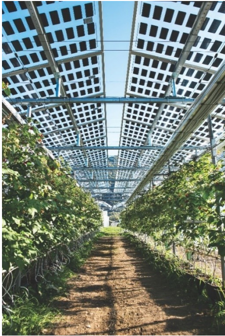
Impianto Agrivoltaico sopra una piantagione di lamponi, impianto di prova a Conthey, © Insolight
