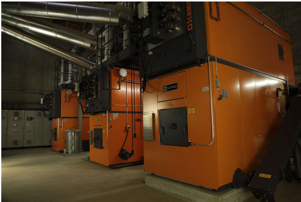
Fours à bois dans la centrale de chauffage à distance d'Eischoll
