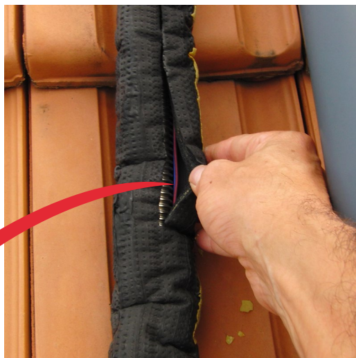
Câble de la sonde de température en contact direct avec la conduite chaude
