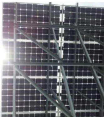
Illustration 17 : Modules solaires bifaciaux avec système de montage inadapté. L'ombrage généré par les profilés porteurs diminue la production énergétique de la face arrière du module ; source : Renewable Energy World
