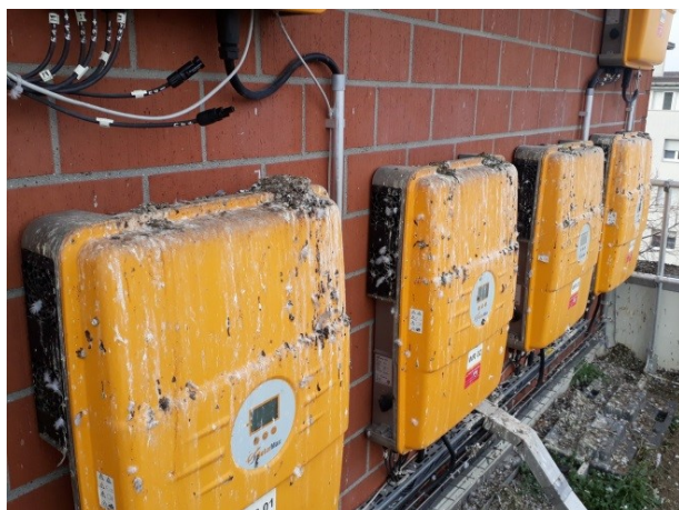
Illustration 4 : Onduleurs encrassés, Jendra Power SA
