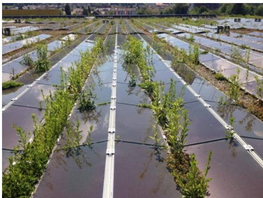
Illustration 13 : Végétation sur une toiture végétalisée ; installation photovoltaïque orientée est-ouest, Dr. Stephan Brenneisen, ZHAW Wädenswil
