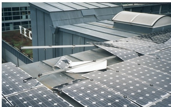
Illustration 3 : Endommagement de module après une tempête, Edisun
