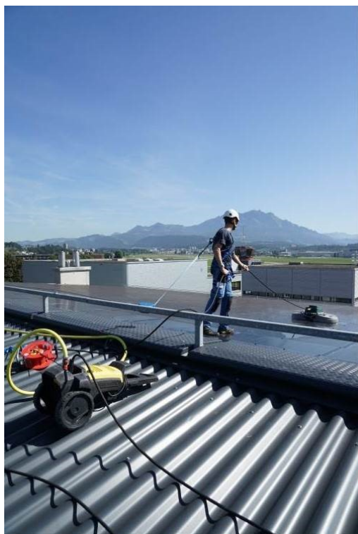
Illustration 10 : Nettoyage de l'installation solaire, BE Netz AG
