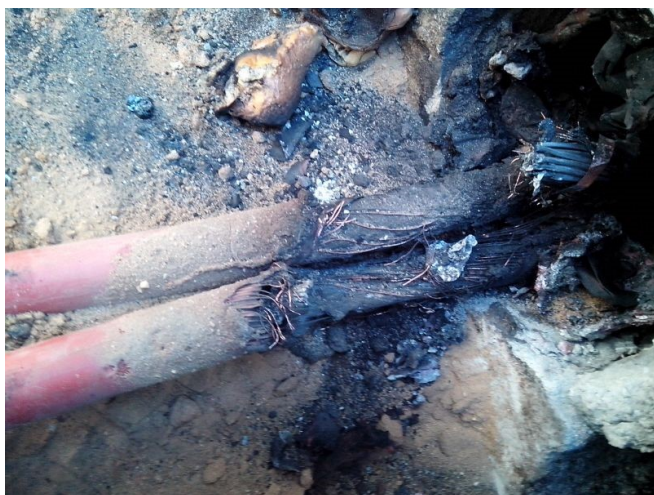
Illustration 7 : Incendie de câbles, Jendra Power SA
