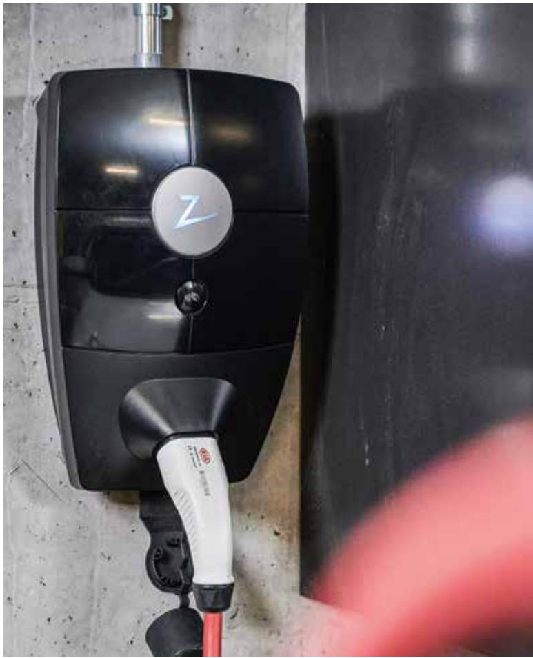
Station de recharge dans le lotissement Ruggächern à Zurich.
