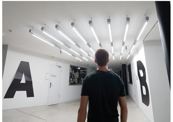
La Haute École d'art de Zurich sur l'espace Toni-Areal applique des tubes LED de LEDCity dans les corridors et les cages d'escaliers. Photo: LEDCity
