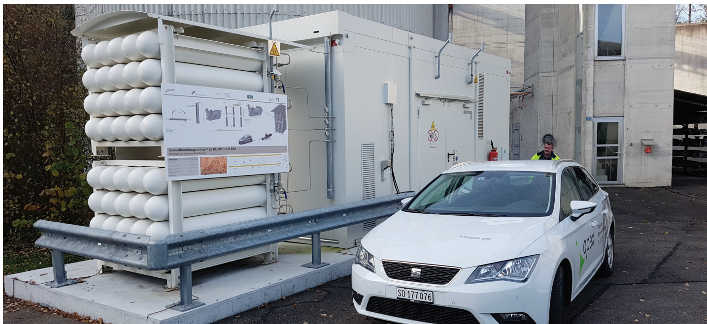
Station de biométhane sur le site de la station d'épuration des eaux usées (STEP) de Schönenwerd (SO): le biogaz de la STEP est «enrichi» avec une installation de traitement membranaire (installée dans le conteneur au milieu de la photo). Le biométhane est ensuite stocké dans des bouteilles sous une pression de 300 bar, prêt pour le ravitaillement des voitures au gaz. Photo: Apex
