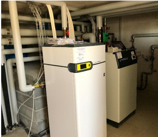
Photo 5 : PAC module Interieur
