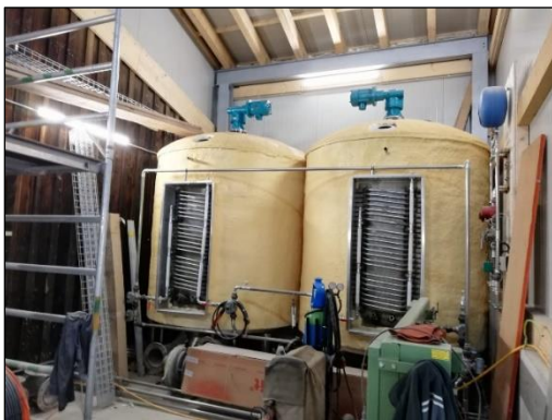
Figure 2: État des travaux: deux nouveaux réservoirs destinés à la stérilisation ont été installés (illustration: wigako) Étape de stérilisation en amont: pour la pasteurisation de déchets soumis à des mesures d'hygiène à >70°C, 1h
