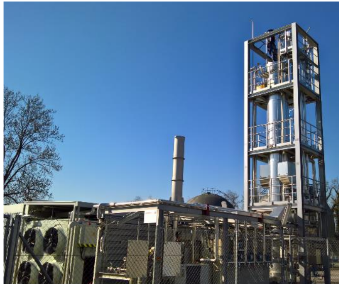
Figure 4 : Refroidisseur de processus, skid pour liquides et tour de réacteur
