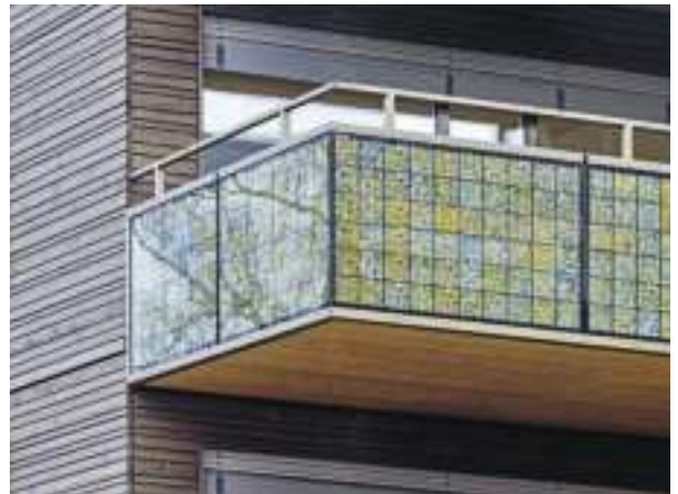
GARDE-CORPS DE BALCONS AVEC MODULES PV POLYCRISTALLINS POUR L'IMMEUBLE D'HABITATION DE LA ZWYSSIGSTRASSE, ZÜRICH Architecture : kämpfen für architektur AG, Zurich
