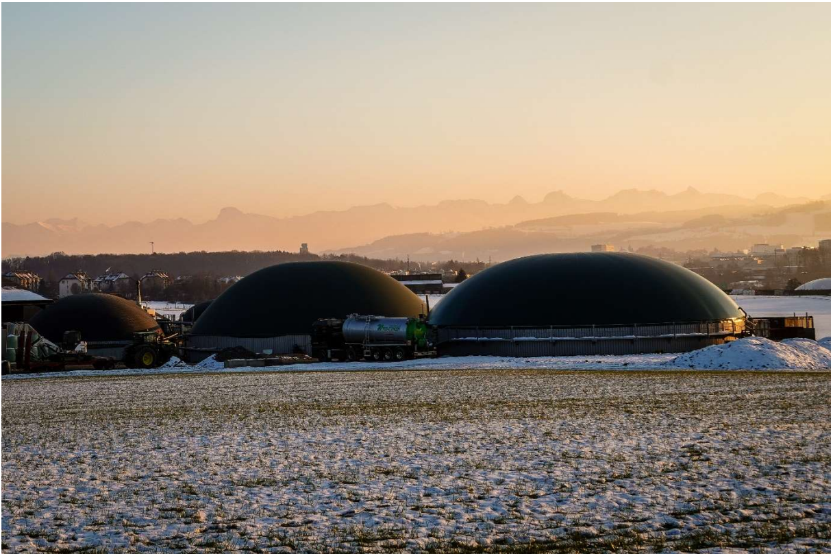
Installation de biogaz dans la région de Berne
