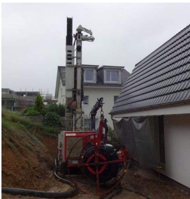
Figure 3 Installation à proximité d'un bâtiment avec façade recouverte
