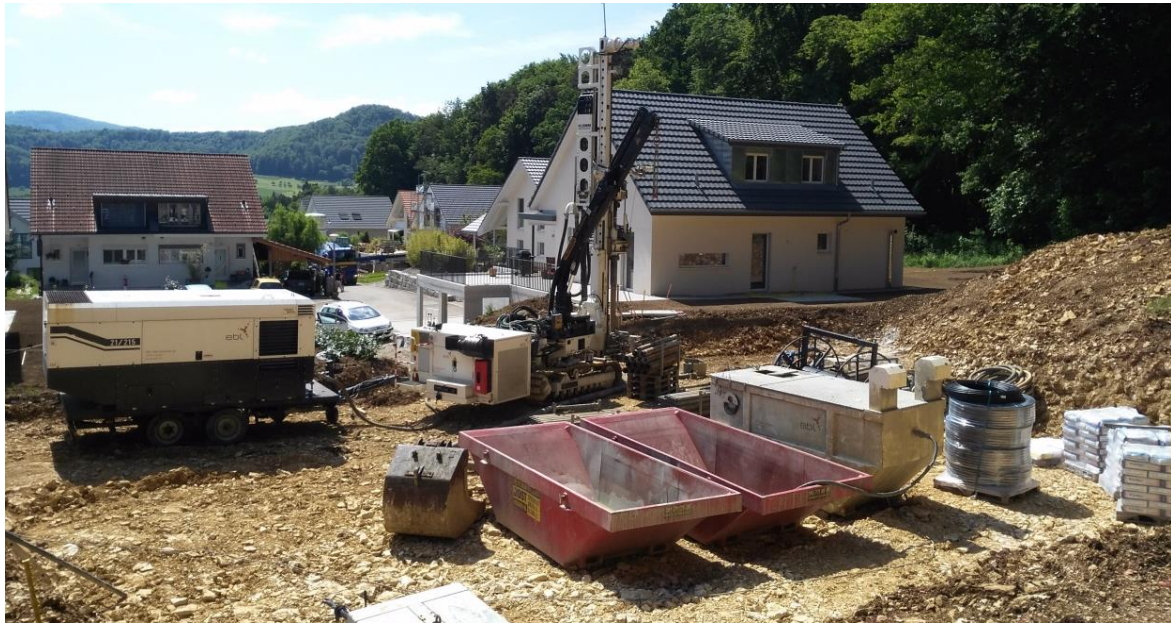
Figure 2 Forage géothermique avec machine de forage, compresseur, benne de récupération des boues, ciment et sonde
