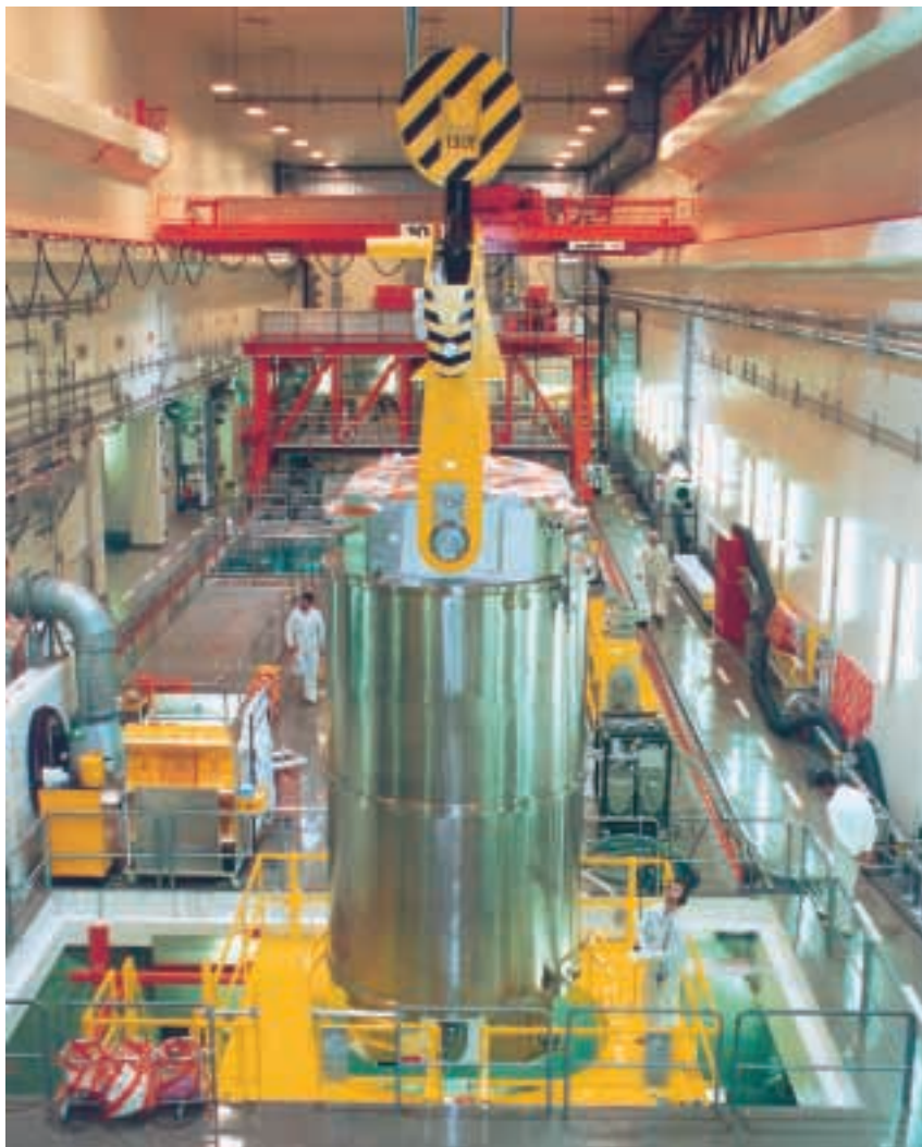
Hotte de transport pour assemblages combustibles épuisés équipée de sa protection contre la contamination, prête à l'immersion dans le bassin de chargement
