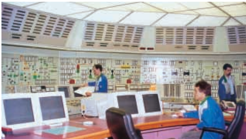
Coup d'oeil dans la salle de commande de la tranche II de la centrale nucléaire de Beznau
