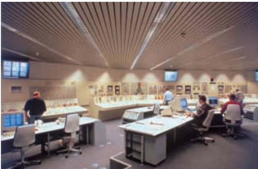
Coup d'oeil dans la salle de commande du simulateur de la centrale nucléaire de Mühleberg
