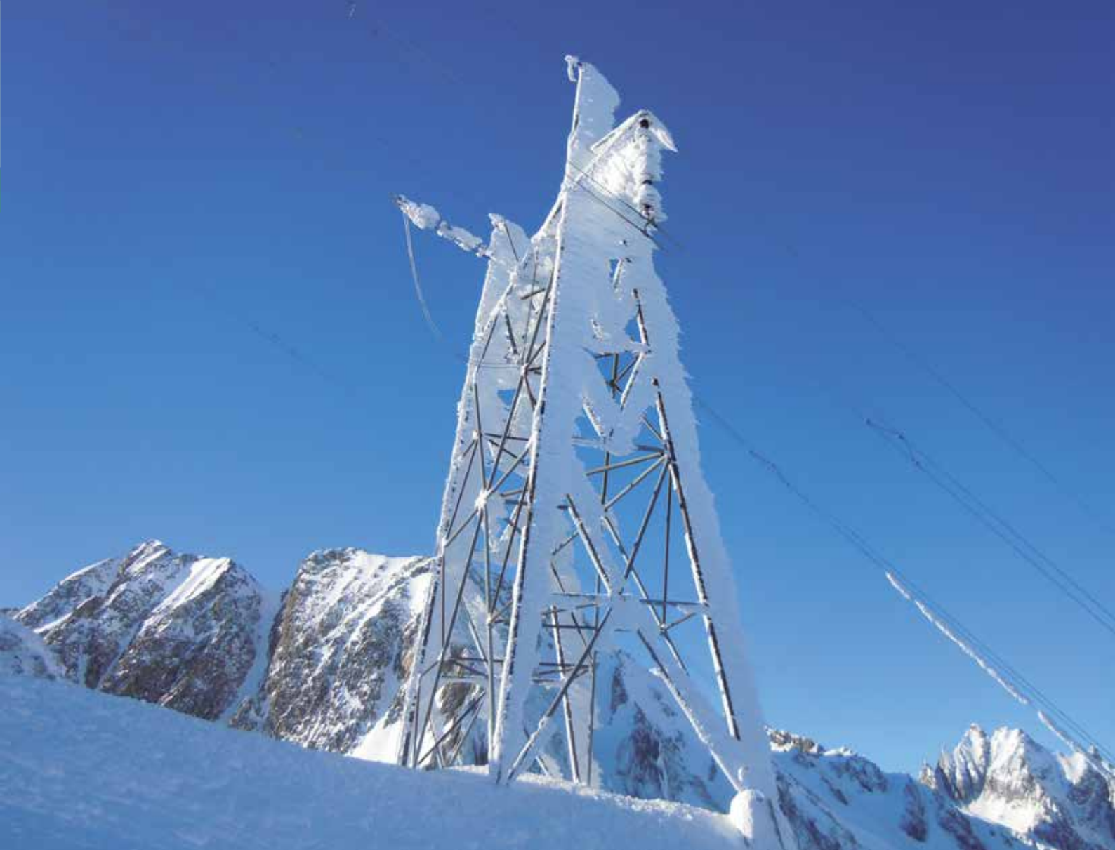
Forte formation de givre sur un pylône de la ligne du Lukmanier après la tempête « Andrea » en janvier 2012.
