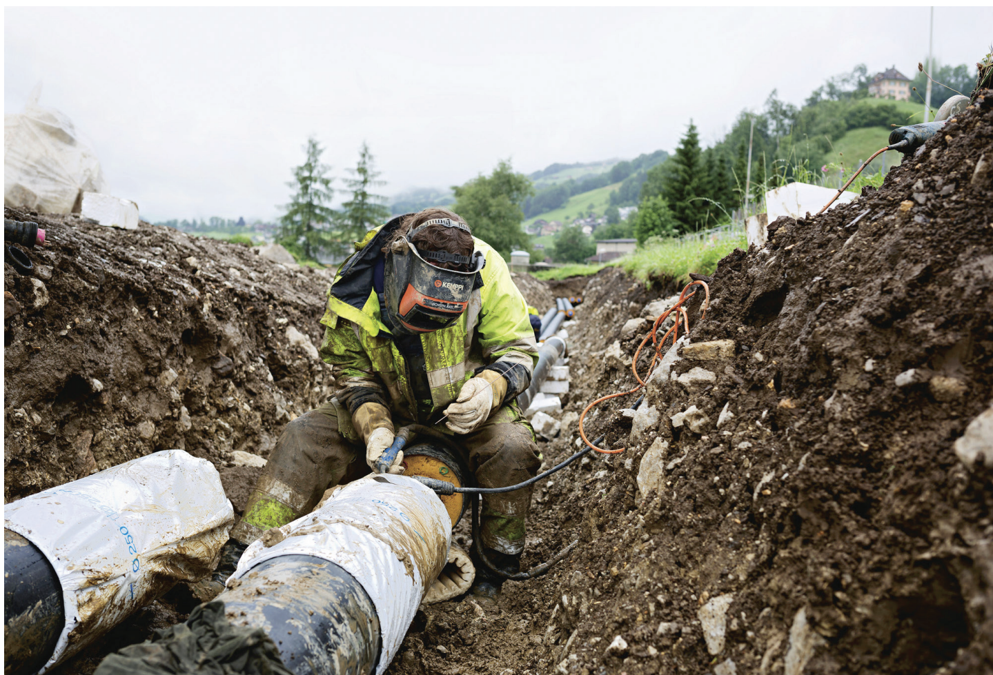
Les réseaux de chauffage à distance requièrent une bonne isolation pour éviter au mieux les pertes. Le réseau de chaleur de la société Agro Energie Schwyz AG (image) dispose de la meilleure isolation (catégorie III). Photo: Gabi Vogt
