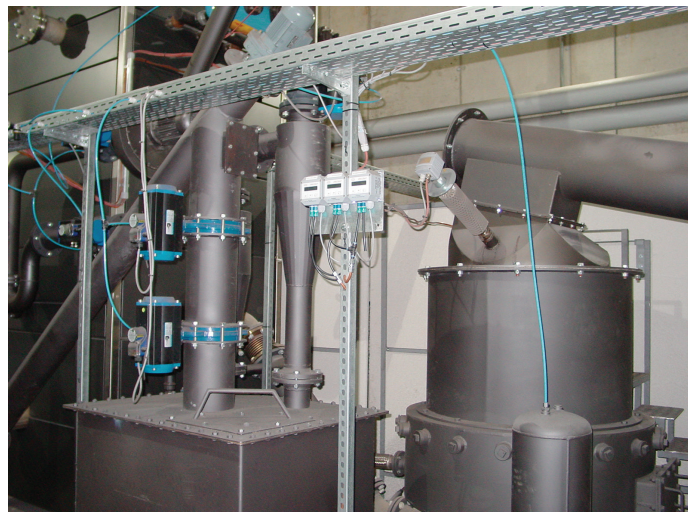
Vue sur l'installation de gazéification du bois de la société Josef Bucher AG à Escholz matt (LU) : le gaz de bois est généré à droite du gazéificateur rond. Photo : Josef Bucher AG
