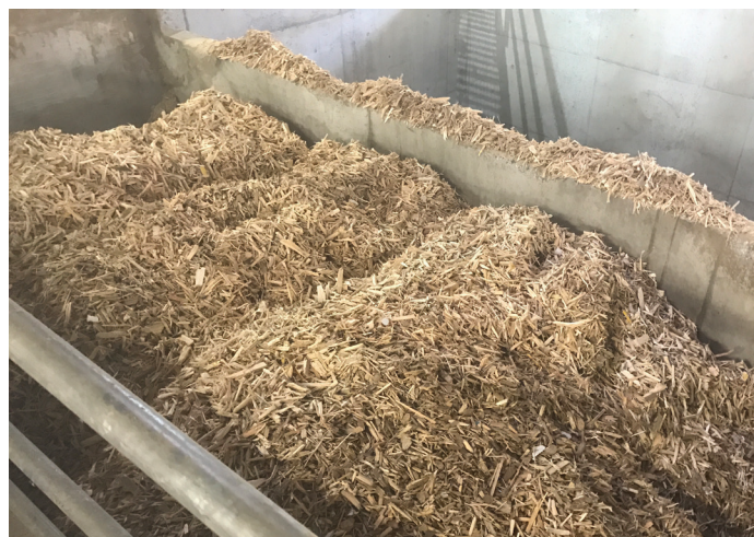
L'installation de cogénération par gazéification de Stans (NW) utilise du bois de récupération naturel pour la production d'énergie. Photo : B. Vogel
