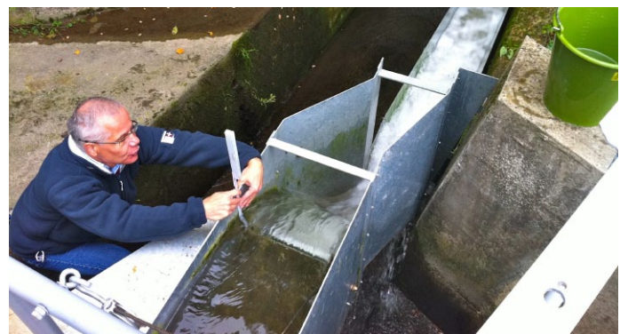
Passé à poissons pour la dévalaison de la petite centrale sur la Versoix (Christian Junker, directeur d'EcoScan) (source: T. Estier)
