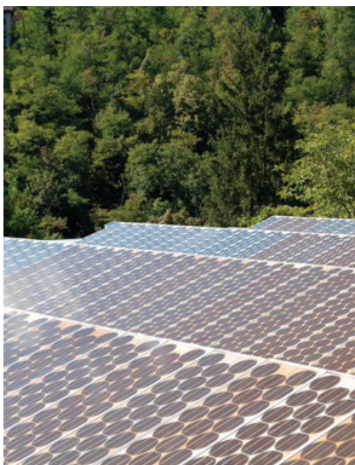
La première installation PV couplée au réseau a été mise en service en 1982 à la Haute École spécialisée de Canobbio (TI). Photo : SUPSI
