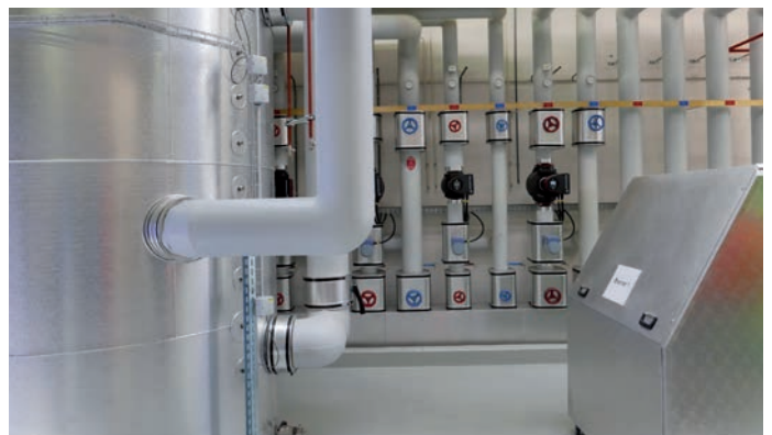
L'accumulateur de chaleur de 7000 litres, la pièce maîtresse de la nouvelle centrale de chauffage, accumule la chaleur dégagée par le compresseur d'air comprimé et la postcombustion catalytique
