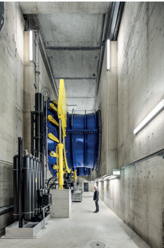
L'intérieur ultramoderne de la centrale hydraulique de Hagneck.
