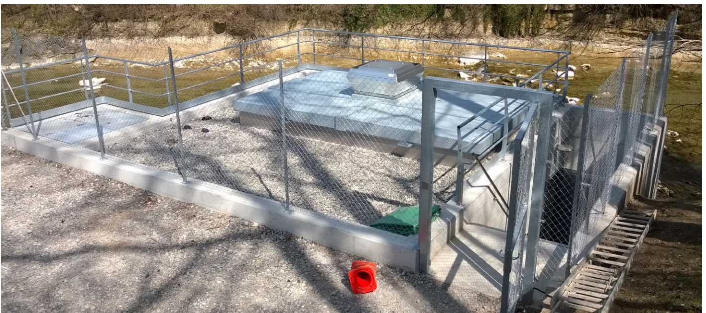
Le local de turbinage, au bord de la Töss
