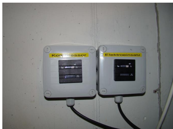
Figure 3 : Compteurs des heures de fonctionnement et d'impulsion pour le compresseur et le chauffage d'appoint
