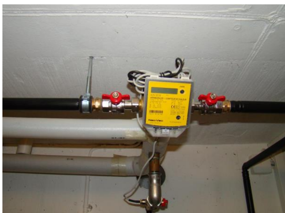
Figure 2 : Compteur de chaleur dans la conduite d'eau froide et deuxième sonde dans la conduite d'eau chaude
