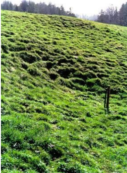
Figure 8b : Tassement du corps de la digue
