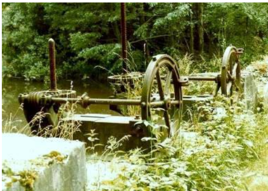
Figure 8f : Etat de composants électromécaniques
