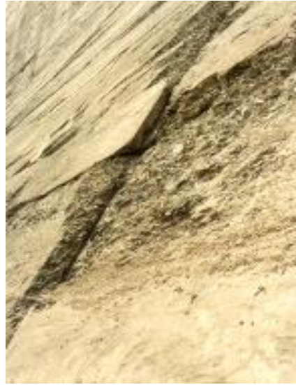
Figure 8c : Eclatements du béton sur un barrage
