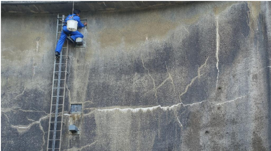
Figure 8d : Formation de fissures sur un barrage
