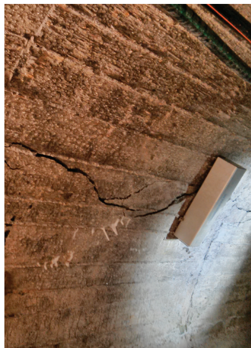
Fissures sur le barrage de Salanfe dans le canton du Valais en raison de la réaction alcali-granulat. À droite de l'image se trouve un appareil pour la surveillance de la formation de fissures. Photo : Cyrille Dunant
