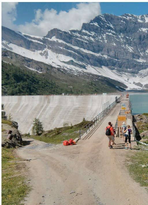
Le barrage de Salanfe au-dessus de Martigny (VS) a été assaini il y a deux ans après la découverte de fissures dues à la RAG. Photo : Cyrille Dunant
