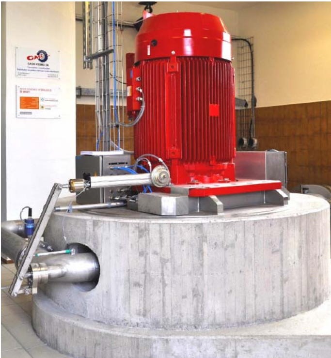
Le nouveau turbogroupe de l'usine de Brent ( Q = 84 l/s, H = 122 m, P_e = 80 kW, E_e = 380'000 kWh/an) (source: Romande Energie)
