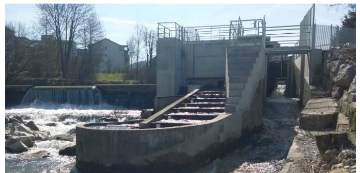
Passé à poissons pour la montaison et la dévalaison de la PCH de Hard
