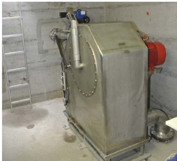
Le turbogroupe, dans l'infrastructure du réservoir d'eau minérale de Lischana
