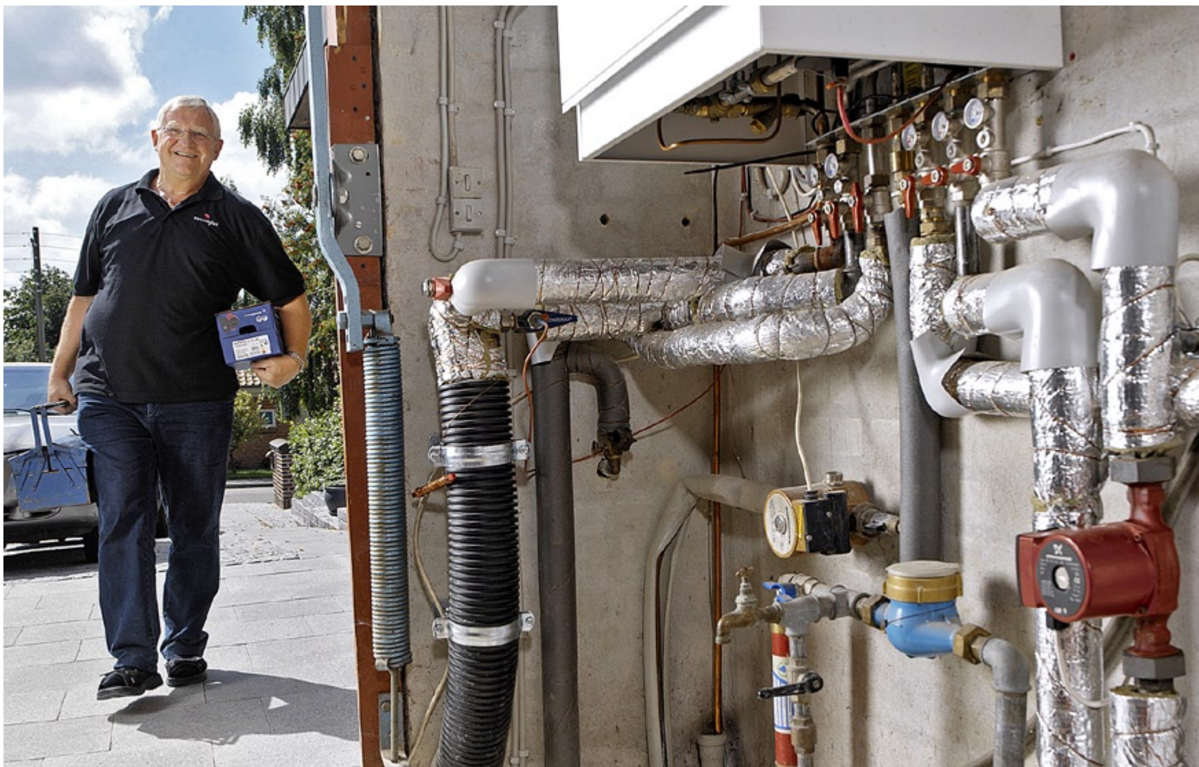
Les vieilles pompes de circulation surdimensionnées devraient être remplacées par un appareil plus performant de classe A. On pourrait aussi correctement isoler les conduites de distribution.
