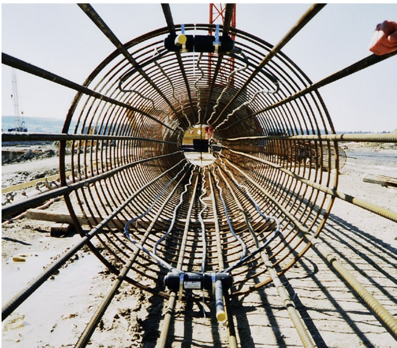
Les pieux énergétiques mis en œuvre dans l'aéroport de Zurich, assurent l'échange de chaleur et la stabilité de l'ouvrage.
