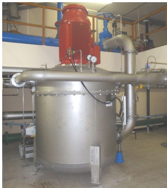
Centrale de Haute Pierre : turbine Pelton à contre-pression utilisant l'eau potable de Morges
