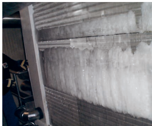
Photo: Évaporateur givré. L'air ne traverse plus qu'une partie de la surface.
