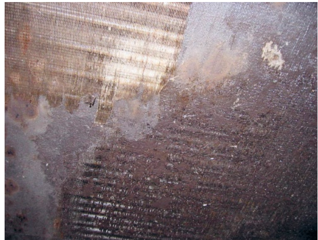
Photo: Refroidisseur d'air souillé, les lamelles se ferment lentement.
