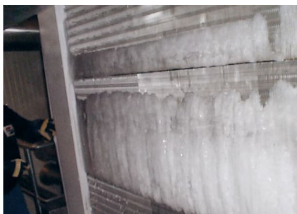
Photo: Évaporateur givré. L'air ne traverse plus qu'une partie de la surface.
