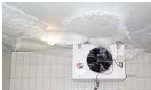
Figure: Plaques de glace au plafond et sur le mur
