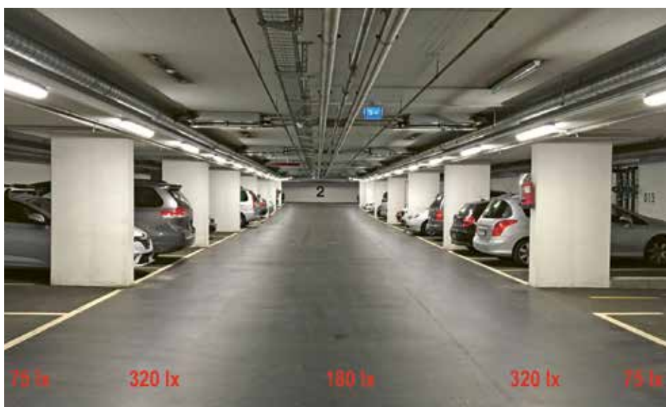
Illustration 6.20: L'éclairage et le niveau d'éclairage mesurés après la rénovation.
