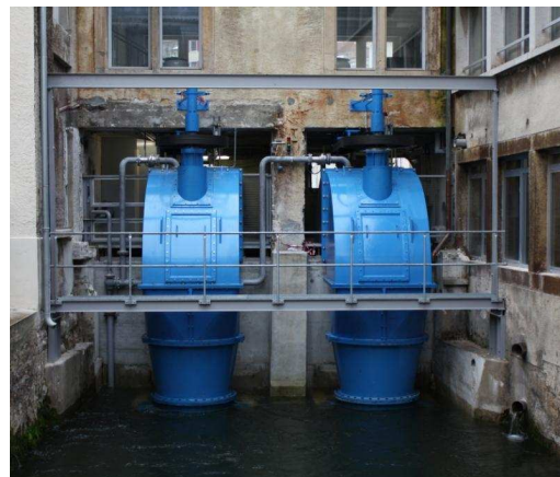
Les turbines siphon installées à Vallorbe (40 kW x 2) (© Mhyllab)
