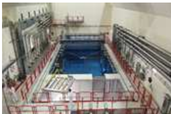
Les éléments de combustible irradiés sont aussi entreposés dans les dépôts intermédiaires des centrales nucléaires (photo: installation d'entreposage en piscine dans la centrale nucléaire de Gösgen). Source: centrale nucléaire de Gösgen
